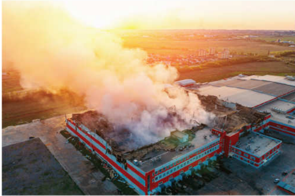
الكثير من المصانع والمنشآت بها وسائل قابلة للاشتعال وغازات تشكل خطر نشوب الحرائق
